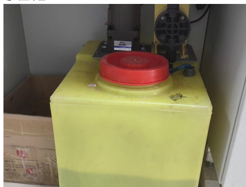
酸液搅拌混合池
