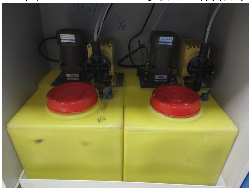
碱液搅拌混合池
