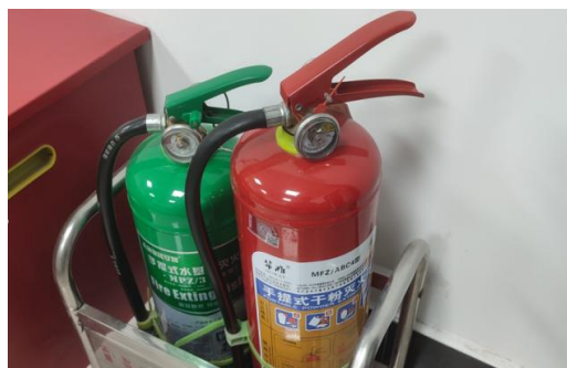
危废间干粉灭火器
